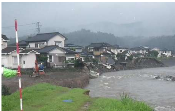
河岸侵食による家屋の倒壊(花月川)
