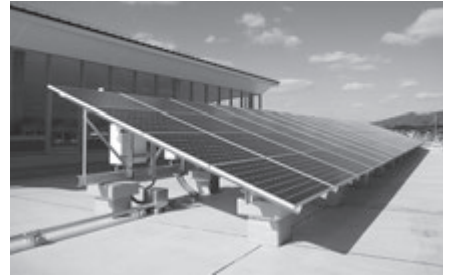
▲三郷中学校の太陽光パネル
