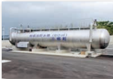
耐震性貯水槽(給食センター敷地内)
