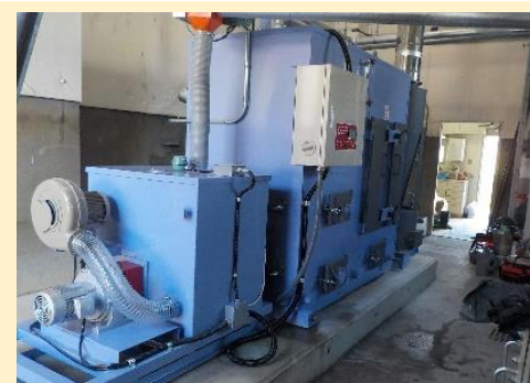
立野共同浴場 ペレットボイラー
